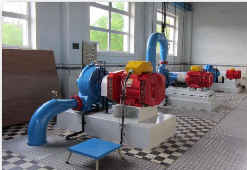
Station de pompage de Fraise
